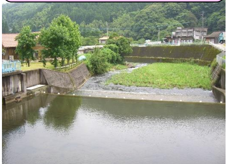
旧キンカンの里付近下流の関 堰の所は深く危険
